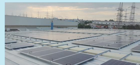
YIMの工場建屋に設置した太陽光パネル
